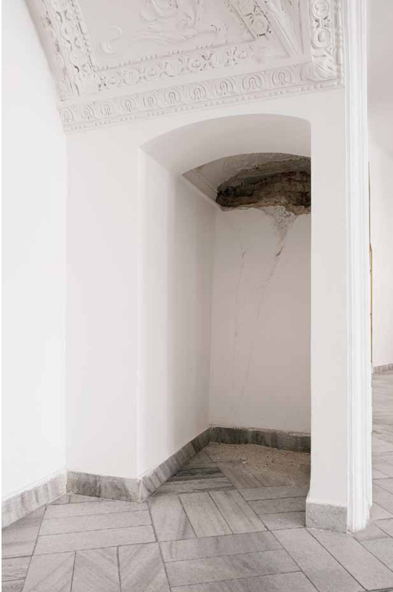
Defekt zákoutí intimity, sondáž, kresba tužkou a kladívkem, 210 × 80 cm Defect of the Secluded Spot of Intimacy, probe, pencil and hammer drawing
